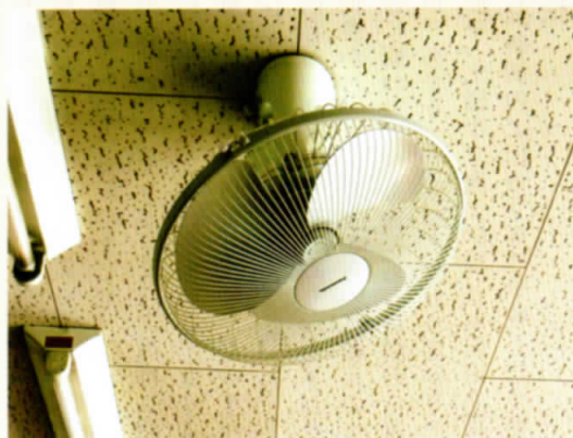
教室に設置された扇風機
